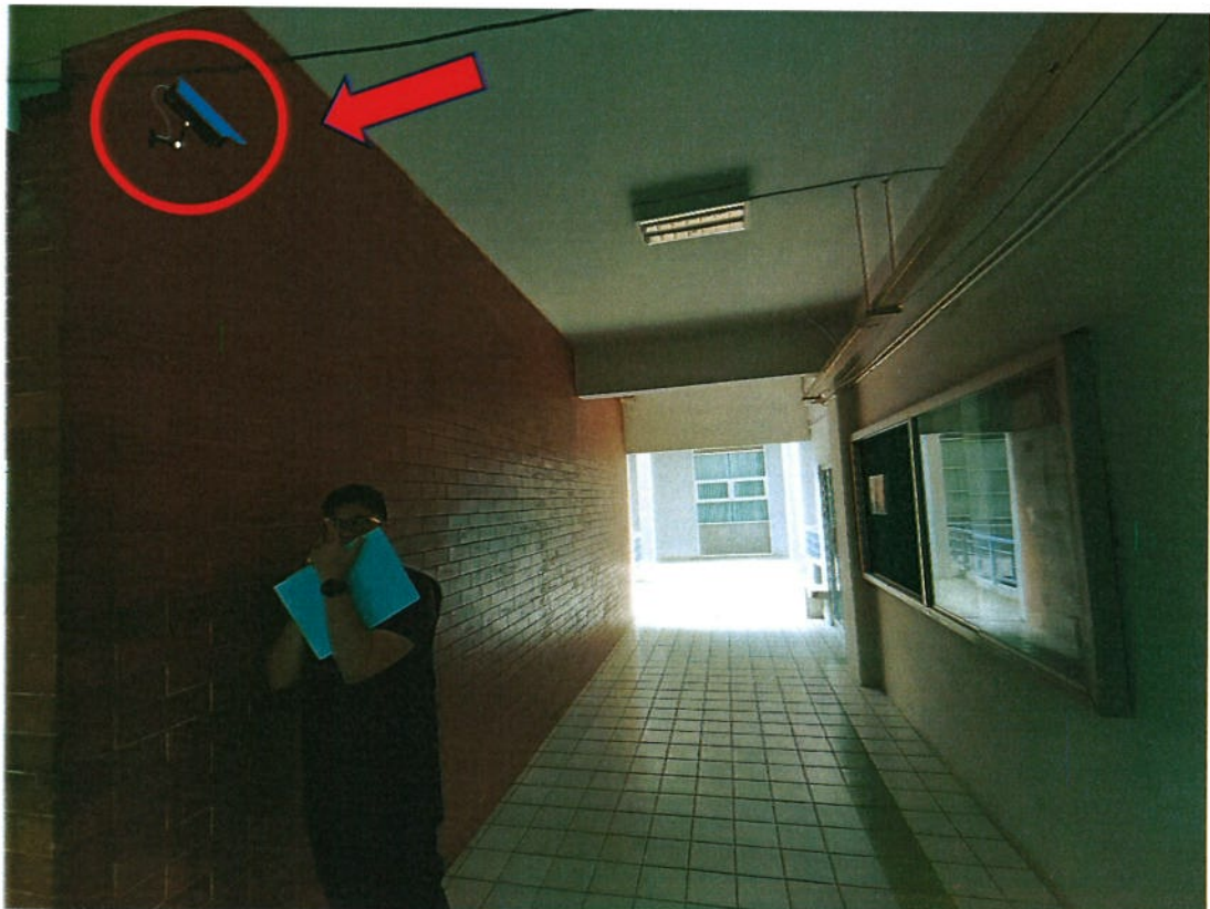
6.อาคาร4 ชั้น2 ทางเดินเชื่อมอาคาร4/1 จำนวน 1 กล้อง
